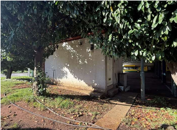
Praonica sa strojarnicom:
