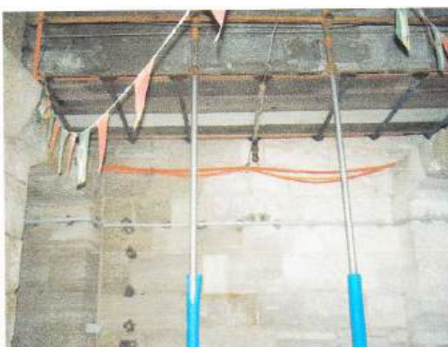
Sl. 30 Skela i zid sa cementnim zakrpama i strujnom instalacijom.
