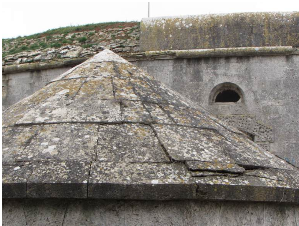
Sl. 68 Primjer smaknutih pokrovnih ploča krovišta južnog kaponira.
