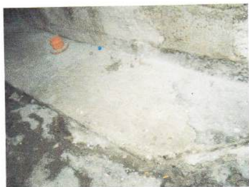
Sl. 156 Cementna nadogradnja poda.
