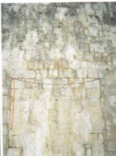
Sl. 51, 52 Zidovi s vidljivim instalacijama struje i mrljama od curenja vode.
