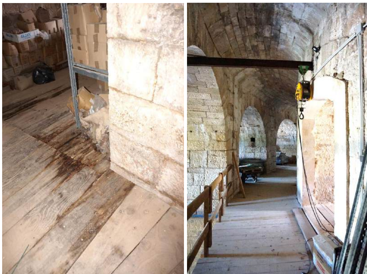
Sl. 7.123.a, b Kat, prostorija 22. Pogled na oštećenja poda od drvenih planjki; Pogled prema istoku.
