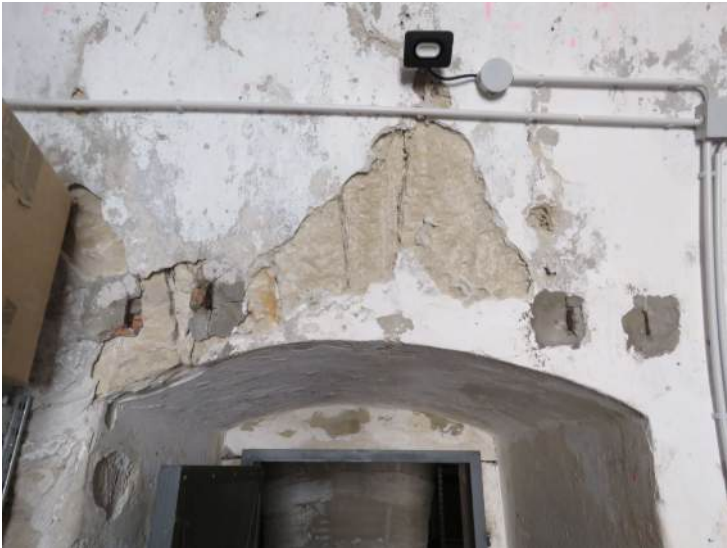
Sl. 64 Detalj trošne žbuke. Ispod su vidljiva oštećenja i popravci kamena.
