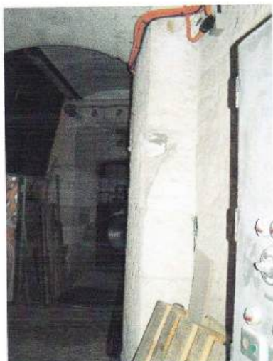
Sl. 132 Instalacije struje i odlomljeni kut.
