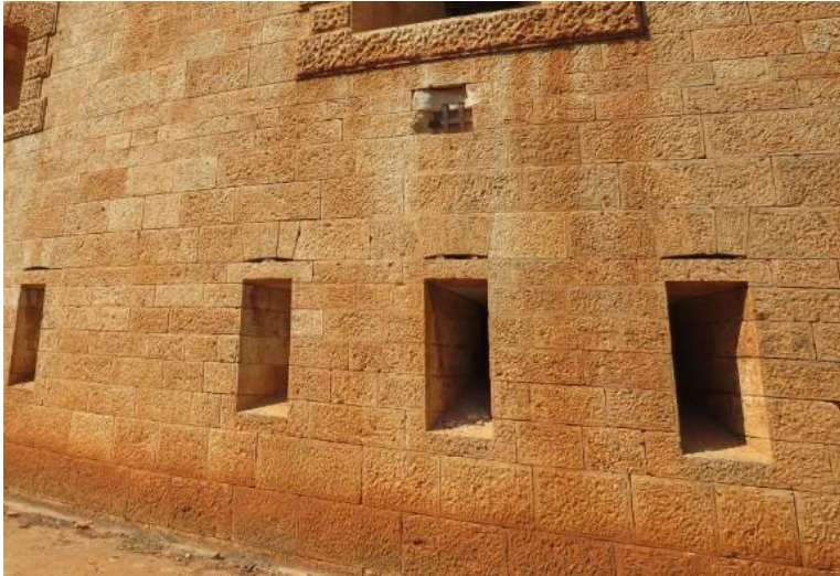
Sl. 82 Široko rasprostranjen depozit tenisita ili praha zemlje crvenice na površine utvrde prema zapadu.
