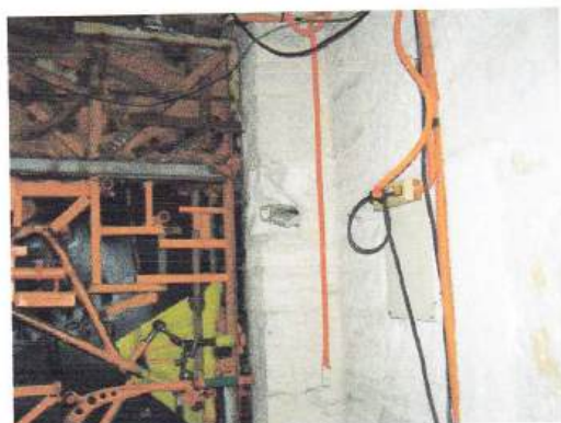
Sl. 120 Instalacije struje.
