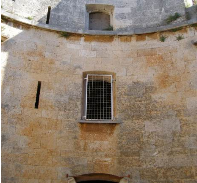
Sl. 81 Narančasta patina na unutarnjim površinama centralnog dvorišta.
