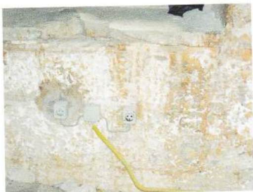
Sl. 185 Instalacije struje.
