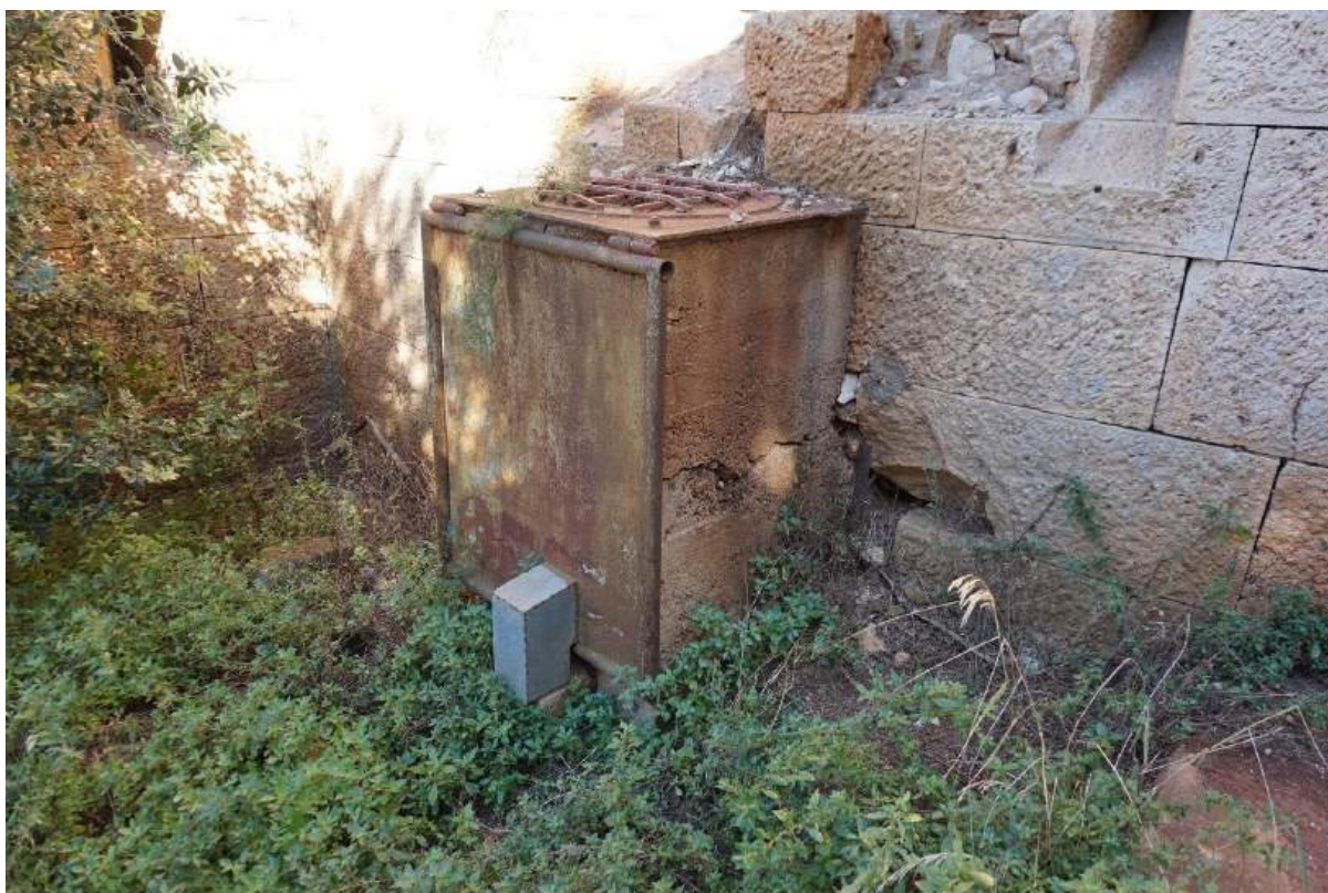
Sl. 7.230. Ostaci instalacije nekadašnje kotlovnice na zapadnom pročelju.
