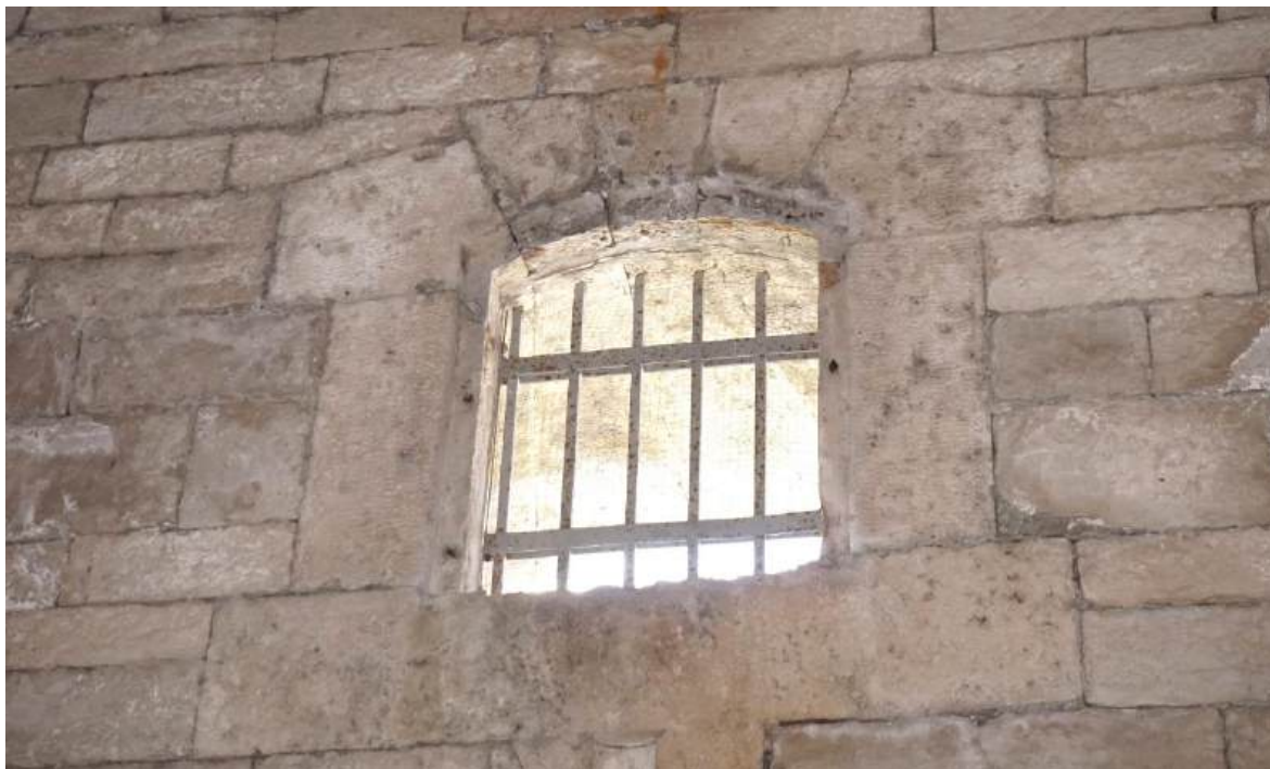
Sl. 2.16. Pogled na topovsku ambrazur kata Fort Bourguignona, iznad prostorije 1 s povijesnom fiksnom zaštitnom rešetkom. Rešetka je instalirana nakon prestanka upotrebe topovskih kazamata u izvornoj namjeni. Na unutarnjem rubu prozorskog otvora vidljiv je utor u kamenom okviru prozora, vjerojatno za dosjed izvornih unutarnjih škura.
