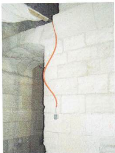
Sl. 78 Instalacije struje.
