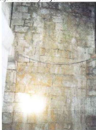
Sl. 61 Mrlje od curenja vode na zidu hodnika.
