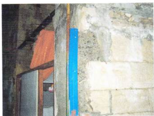
Sl. 5-20 Primjeri željeznih elemenata ugrađenih cementnom žbukom u kamene blokove. Vidljiva su i oštećenja dovratnika.
