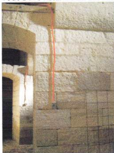
Sl. 60 Instalacije struje.
