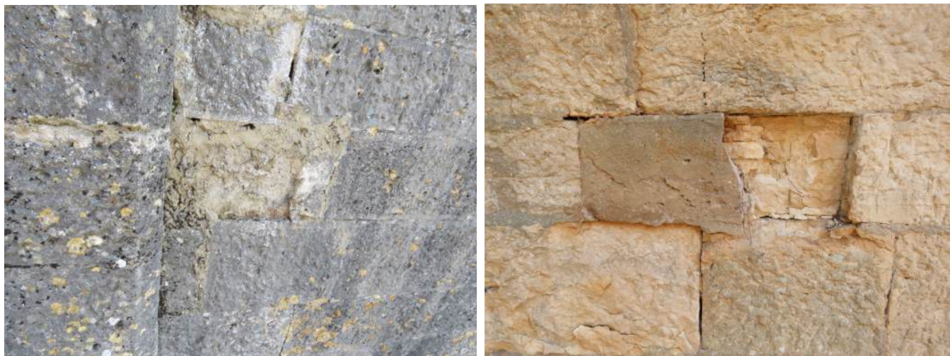
Sl. 43-44 Primjeri nezgrapnih popravaka oštećenih blokova.
