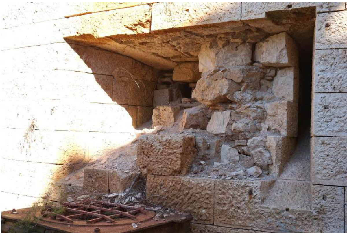
Sl. 3..5 229. Oštećenje zidnog plašta na zapadnom pročelju. Ambrazure kazamata u prizemlju.
