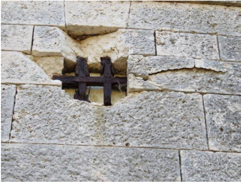
Sl. 72 Pukotina uzrokovana bubrenjem željeza. Jednostruke pukotine manje su zastupljene unutar utvrde.
