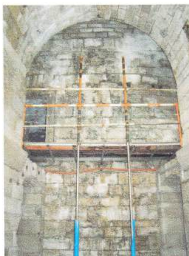
Sl. 39 Skela i zid sa vidljivim mrljama uzrokovanim curenjem vode.
