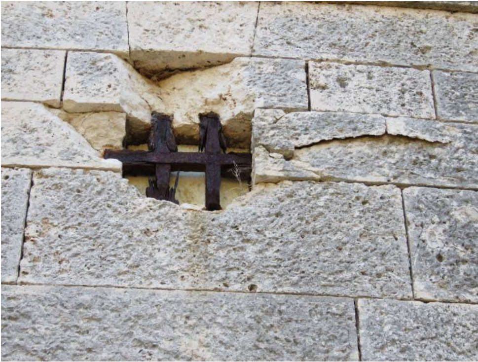
Sl. 41 Detalj izvornog željeznog elementa vanjske strane utvrde ispod razine prozora prvog kata. Korozija je uzrokovala puknuće kamenih blokova s gubitkom materijala.
