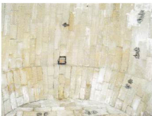
Sl. 75 Svod prostorije, vidljivi su željezni nosači u cementnom mortu te nedostajući dio gdje je vjerojatno vidljiv dio odvodnog kanala na krovu.
