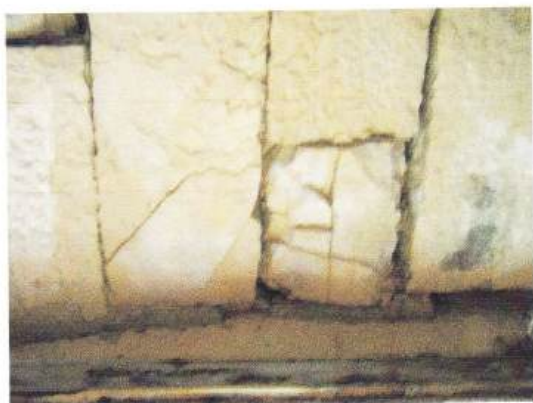
Sl. 1 Puknuće iznad samog ulaza.
