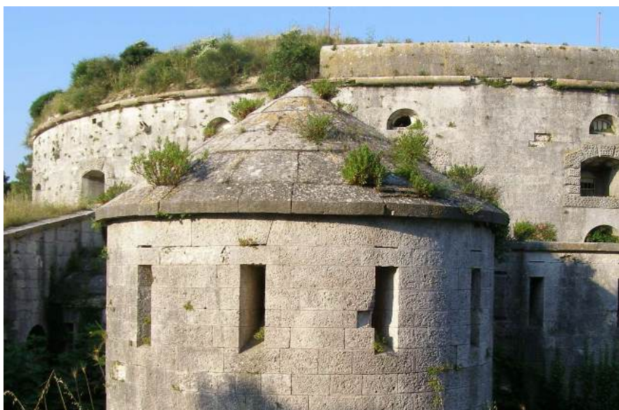
Sl. 22 Krov južnog kaponira 2011. godine, obrastao višim biljem.
