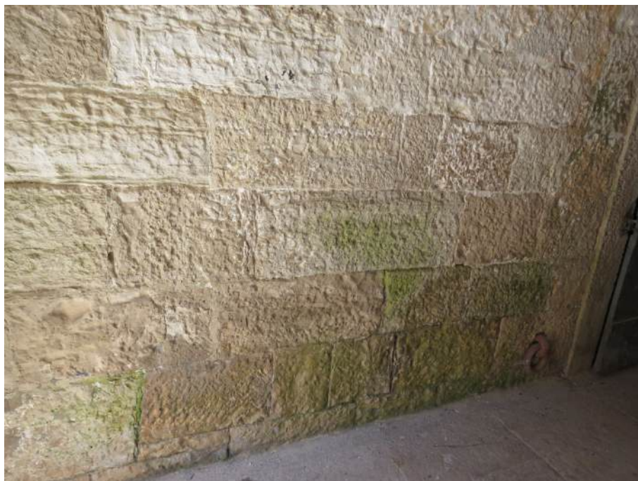
Sl. 57 Kolonije algi na prizemnom dijelu unutarnjeg zida, vjerojatno uzrokovane kapilarnom vlagom.
