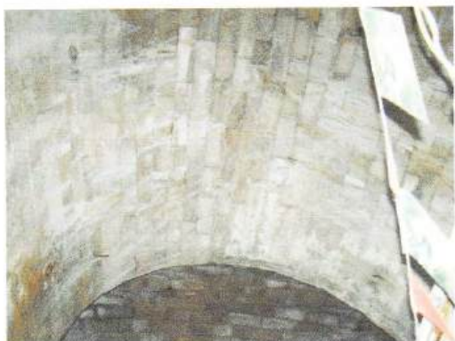
Sl. 31 Svod sa tragovima vapnenog premaza i vidljivim smjerom curenja vode.
