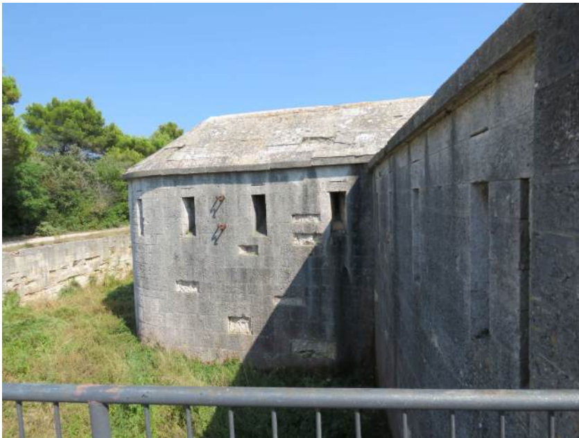
Sl. 38 Pogled na južni kaponir. Vidljive su erodirane kamene ploče kao i željezni, korodirani, elementi ugrađeni u strukturu.
