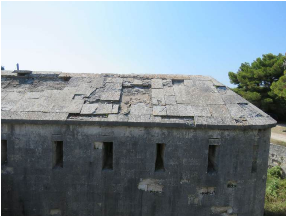
Sl. 67 Primjer dotrajalih zakrpa krovišta južnog kaponira.
