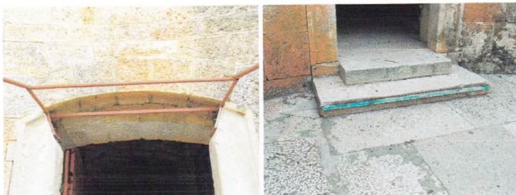
Sl. 241, 242 Učvršćivanja željeznim elementima.
