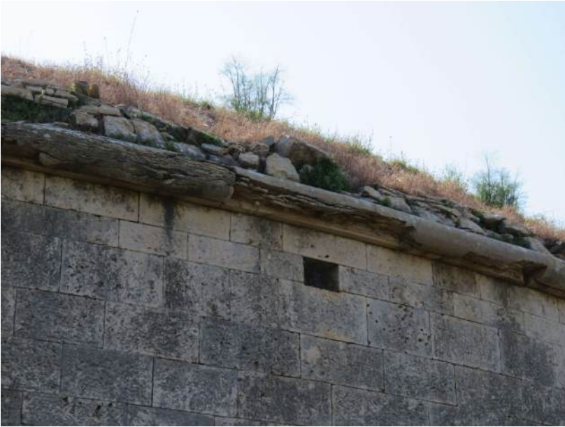
Sl. 73 Mnogobrojne paralelne pukotine kamenih elemenata s vidljivim gubitkom materijala.
