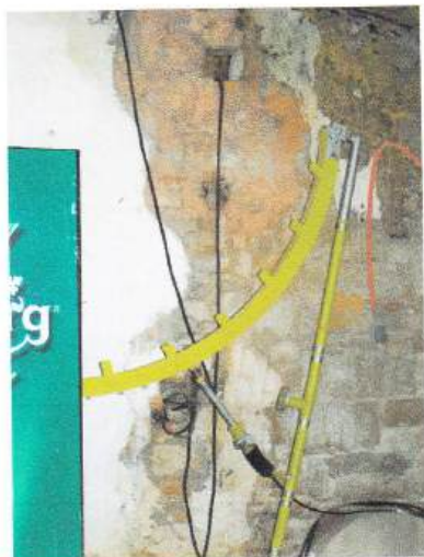
Sl. 161 Instalacije i zid.
