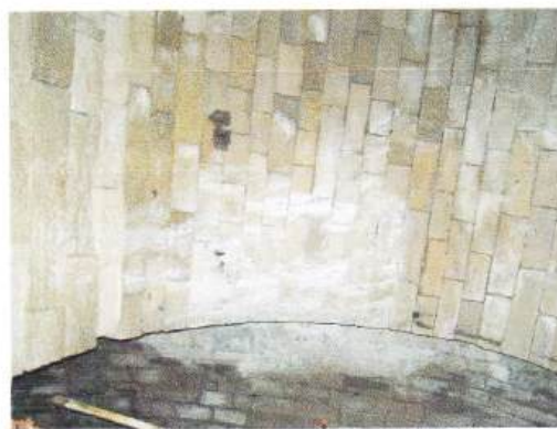
Sl. 40 Svod sa vidljivim smjerom curenja vode.
