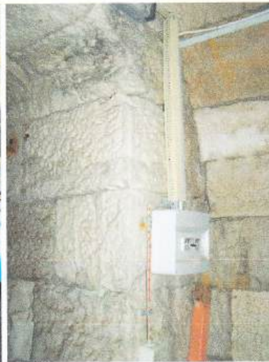
Sl. 210 Instalacije struje.
