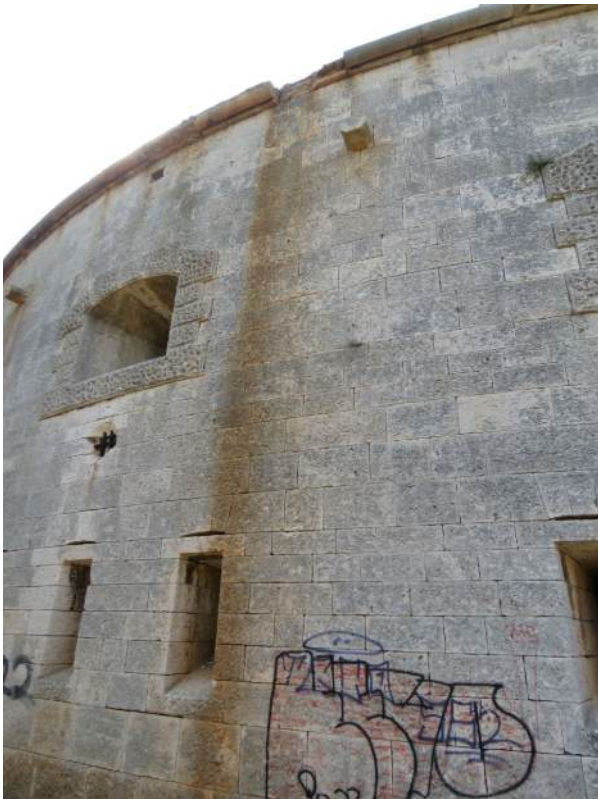
Sl. 39 Pogled na jugozapadni dio utvrde. Pigmentirana kora nastala je uslijed nedostajućeg dijela kamenog prstena krovništā. Prisutni grafiti.
