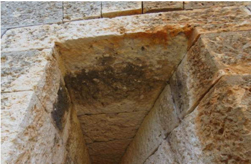
Sl. 77 Crna kora unutar otvora puškarnice na poziciji zaštićenoj od utjecaja vode.
