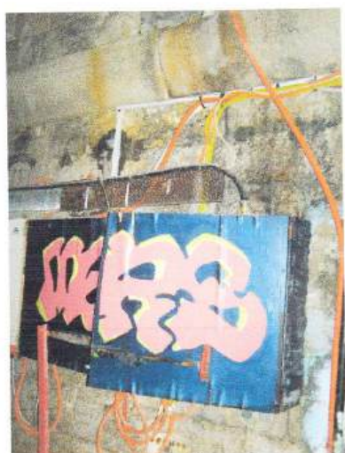
Sl. 150 Instalacije struje.
