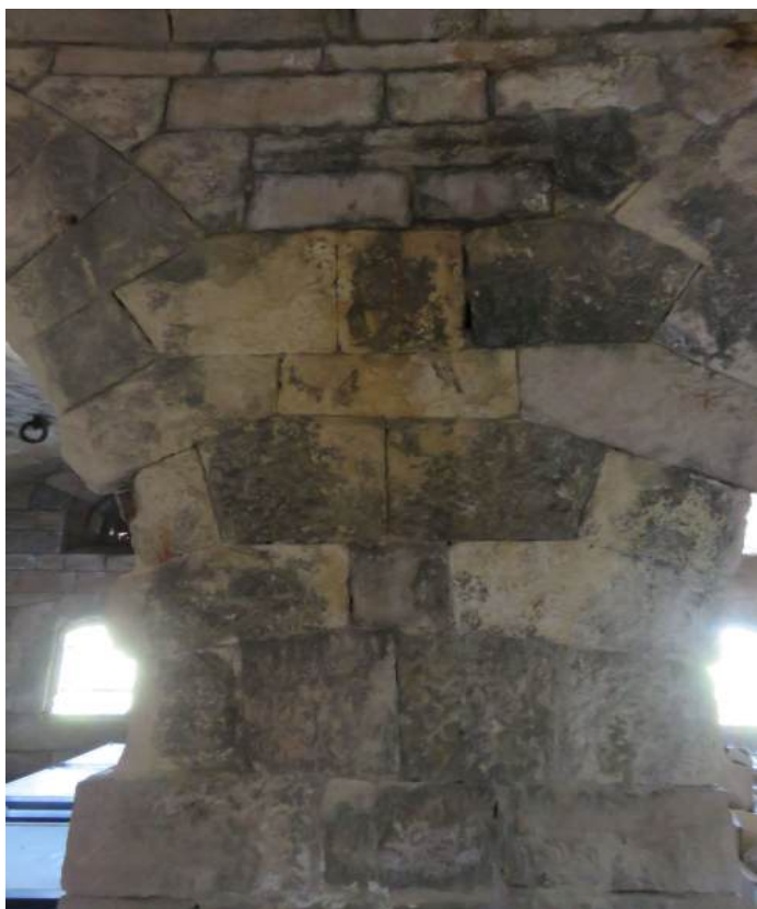
Sl. 58 Kolonije algi na zidu prvog kata uzrokovane curenjem vode iz krovništva.
