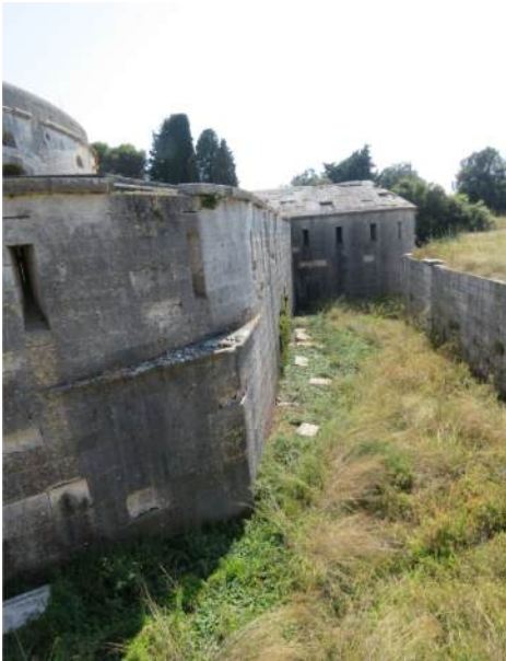
Sl. 45 Kanal na istočnoj strani utvrde. Unutar kanala leže pokrovne kamene ploče zida koje su vandalizmom prevrnete sa svoje izvorne pozicije.
