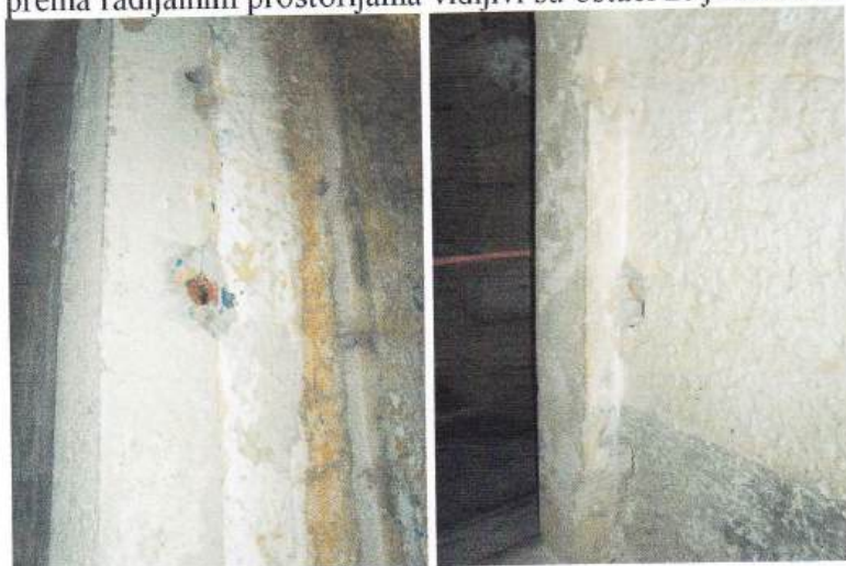
Sl. 181, 182 Oštećeni dovratnici.
