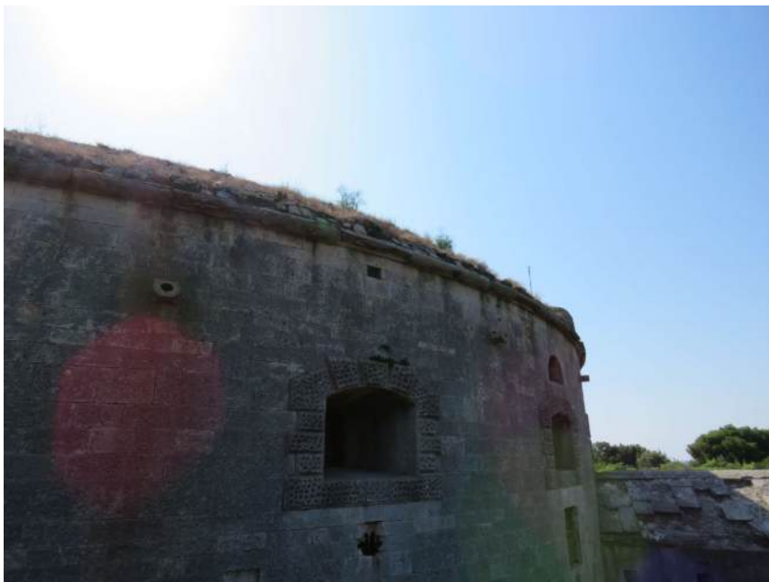
Sl. 21 Pogled na krunište utvrde 2024. godine. Košnja krovista i redovito korištenje sredstva za suzbijanje rasta višeg raslinja na kamenim površinama doprinijeli su usporavanju već prisutnih degradacija.
