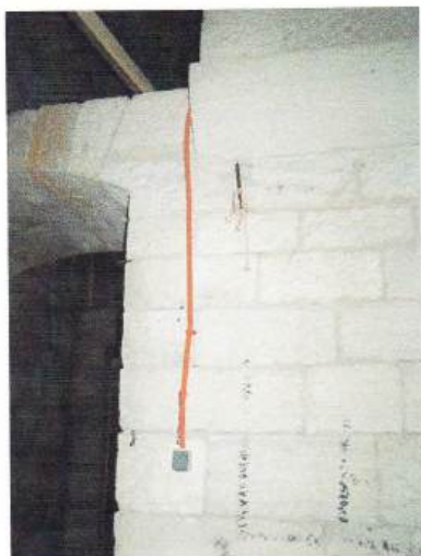
Sl. 86 Instalacije struje.
