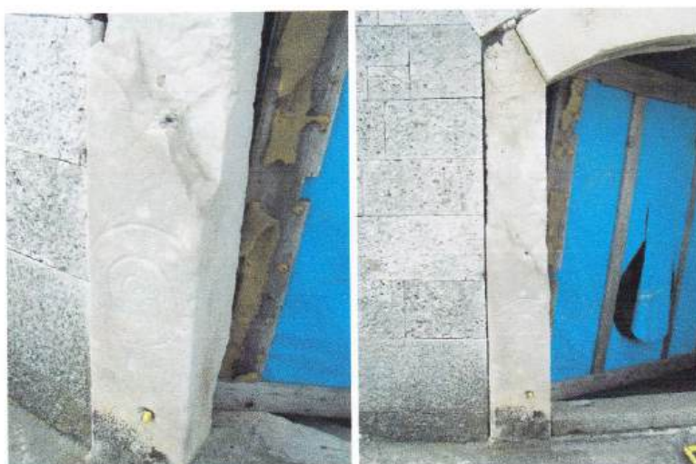
Sl. 230, 231 Uklesana spirala u oštećen i raspucan dovratnik.
