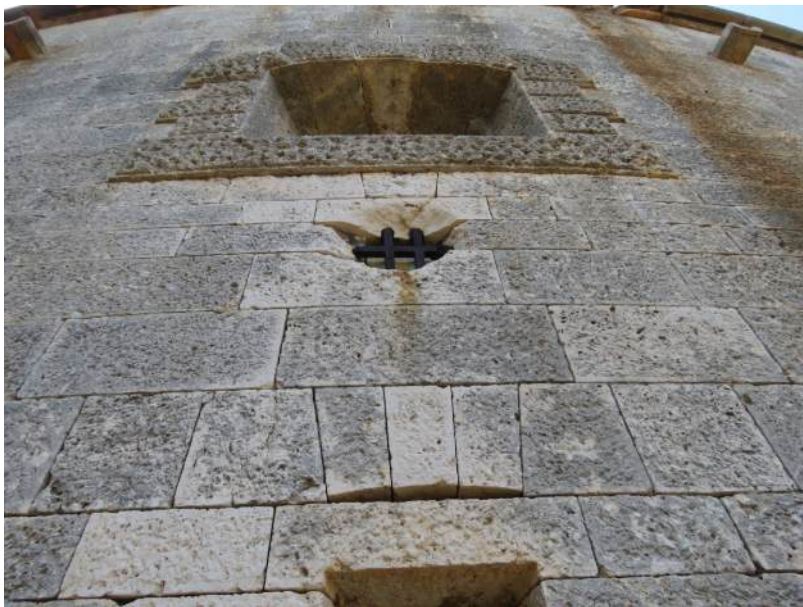
Sl. 40 Primjer izvorne željezne rešetke. Ovakve su rešetke prisutne duž čitavog vanjskog plašta na istoj poziciji ispod prozora prvog kata. Na svim je pozicijama primijećeno lomljenje kamenih blokova uslijed bubrenja korodiranog željeza.
